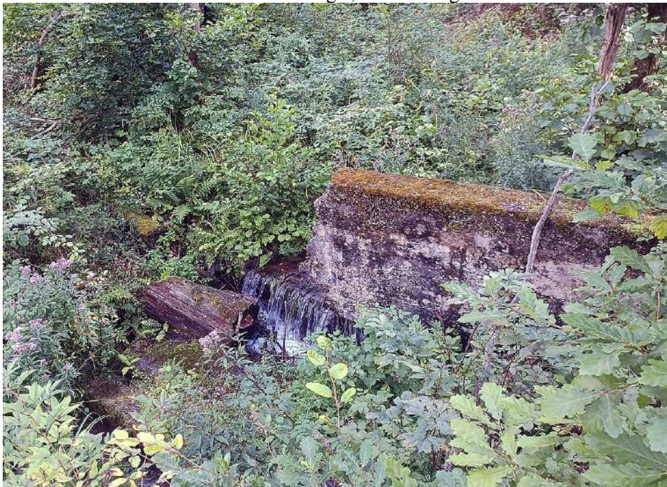
Eingefallene Staumauer im Bachlauf
